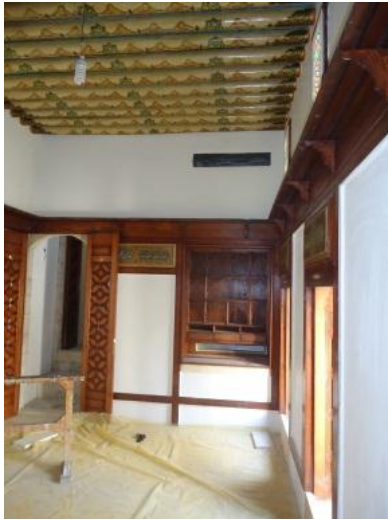
شكل رقم (٣٣) إخفاء جهاز التكييف وكامل تمديداته داخل الملقف - بيت سكاني في الجديدة - عدسة الباحث
